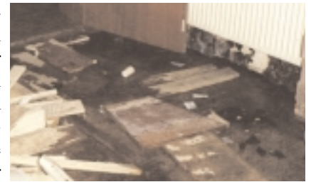
Wenn das Wasser abläuft, wird erst der tatsächliche Schaden sichtbar
