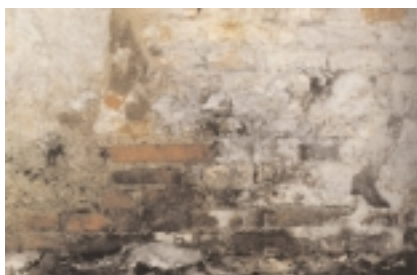
Typische Feuchte- und Salzschäden im Sockelbereich einer Außenwand
